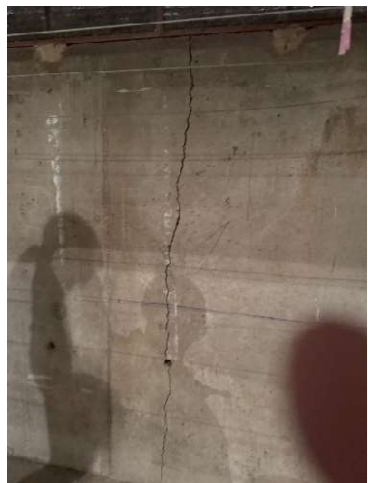
Mur extérieur fissuré côté intérieur
